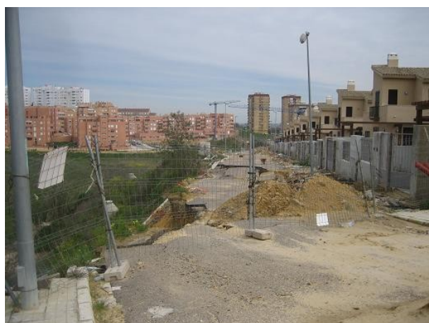
Desplome de la calzada de la Calle Buen Aire.
