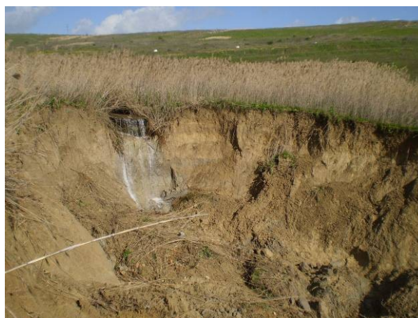
Desplome de tierras en el cauce del Arroyo Alfileres
