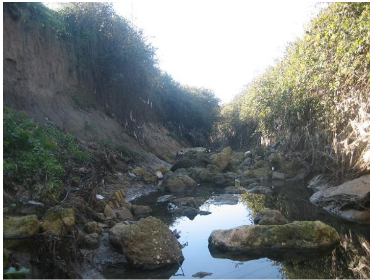
A la salida del soterramiento, es muy visible la erosión del arroyo que paulatinamente incide en el terreno, alcanzando las riberas los 4 o 5 metros en estos momentos.
