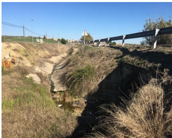
Figura 18. Entrada al arroyo Riopudio del drenaje de la cuneta de la carretera a Salteras, e inicio del proceso de encajonamiento del cauce, que atraviesa dicha carretera y recibe a poca distancia el aliviadero de este municipio. Fuente propia.
