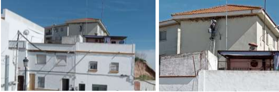
Imagen 3: Fotos realizadas 24/02/2023 que muestra una de las fachadas del Puesto de la Guardia Civil de La Puebla del Río y un operario tirando los nidos de los aviones comunes.
