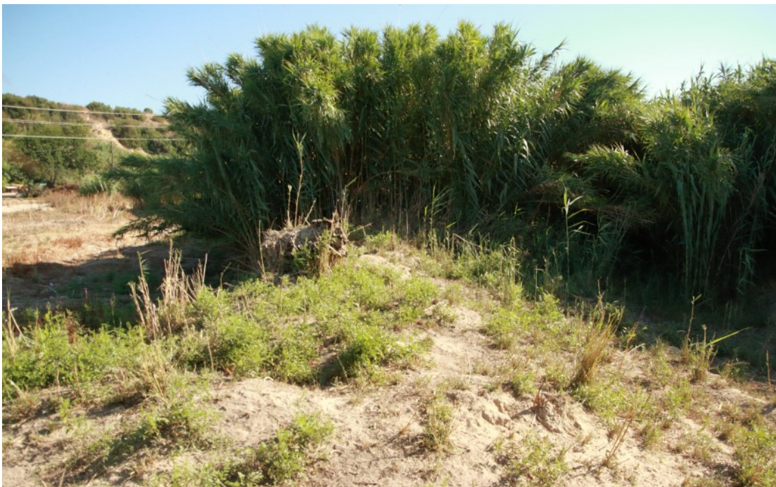
Figura 21: Encauzamiento del Arroyo Porzuna (derecha). Se aprecia cómo el lecho se encuentra más elevado que los campos colindantes (izquierda). La proliferación de caña común ( Arundo donax ) no permite el desarrollo de especies autóctonas.
